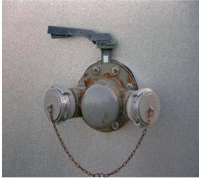
Réserve aérienne avec 2 prises de Ø 100 mm.
