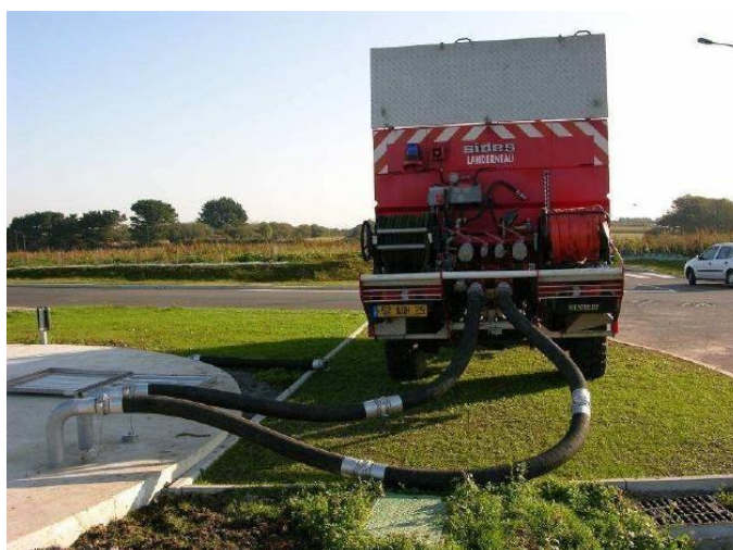
Dispositif de mise en aspiration sur une réserve enterrée de 240 \text{ m}^3 avec 2 sorties de \varnothing 100 mm. Chaque sortie étant sur une canalisation de \varnothing 100 mm.
